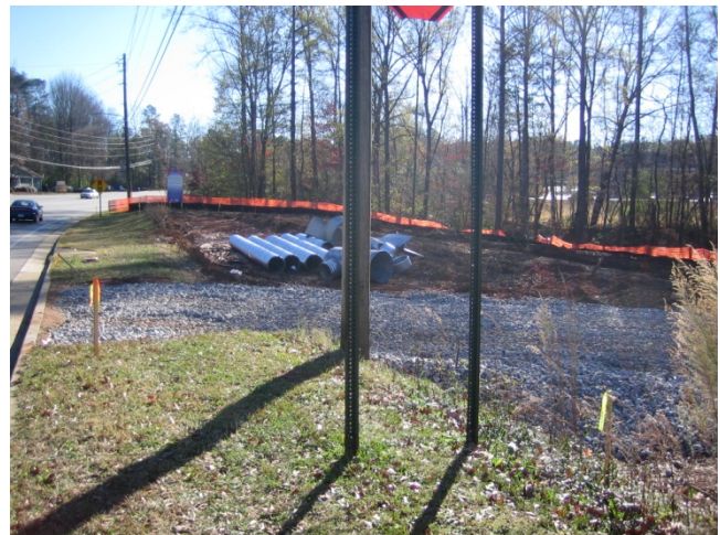
Entrada de piedras al sitio de cosecha de madera—se ayudan prevenir llevar tierra en las calles públicas.
