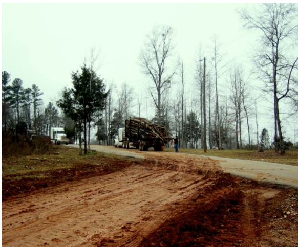
Erosión del mala preparación del sitio.
